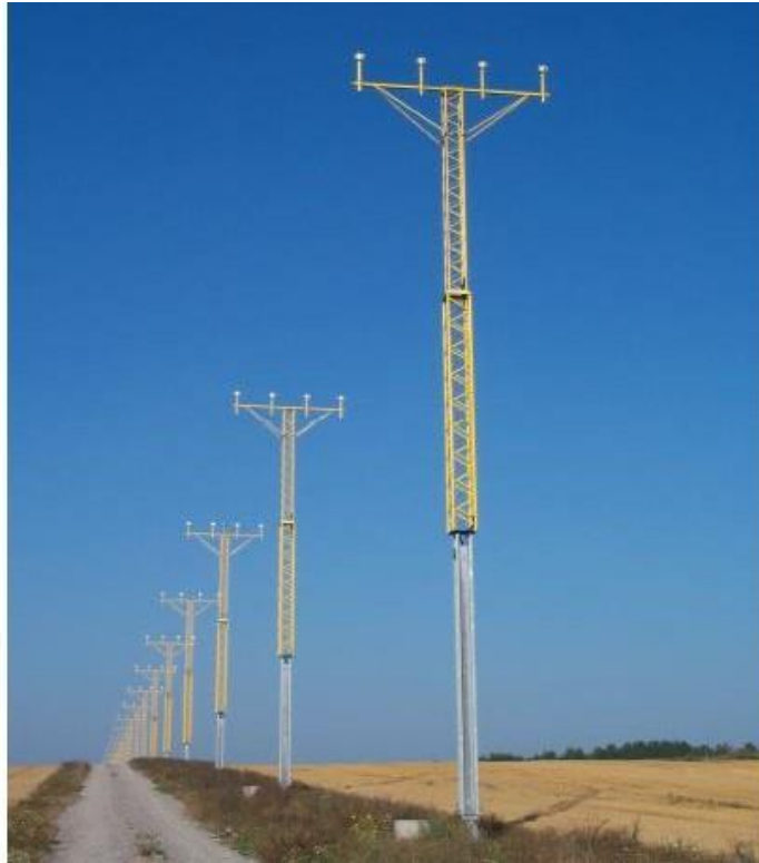
Figura 2-8-1. Torres de iluminación de aproximación de fibra de vidrio sobre estructuras de soporte rígidas
