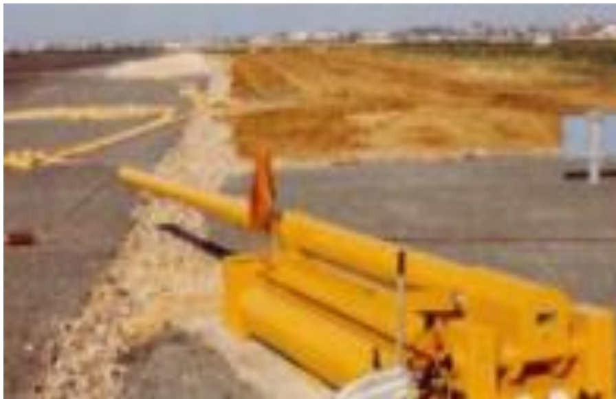
Figura 10-3 Conjunto de levantamiento (Fuente: Fuente: FAC-JETIC 2020)
