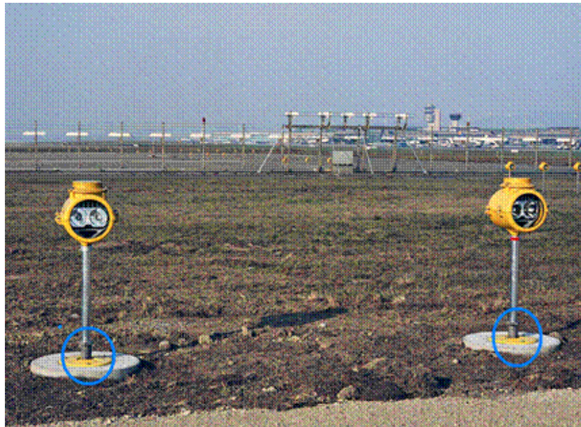
Figura 2-6-4. Ejemplos de Cuplas Frangibles montaje de tubos en Luces de aproximación (Fuente: LAR 154 3ra edición 2020)
